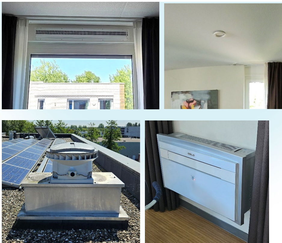
Linksboven: Raamrooster. Rechtsboven: afvoerventiel. Linksonder: dak ventilator. Rechtsonder: Air conditioner
