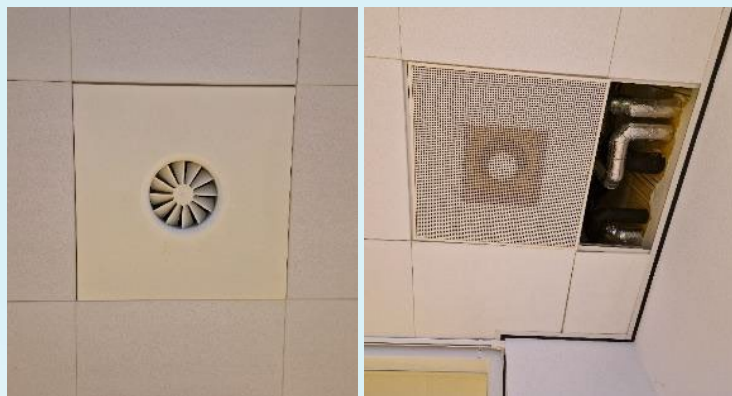
Links: Eén van de drie wervelroosters voor de toevoer. Rechts: Eén van de afvoerroosters en een ontbrekende plafondplaat met zicht op GKW (gekoeld water) én CV-leidingen
