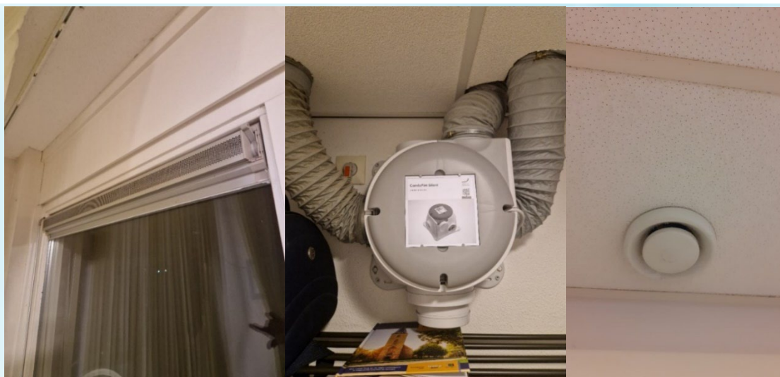
Links: ventilatierooster boven raam. Midden: ventilatiebox in de bergruimte. Rechts: Afvoerventiel in personeelsruimte
